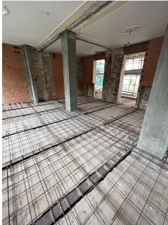
Vista dei rinforzi dei solai SAP in fase di esecuzione e posa delle armature aggiuntive
